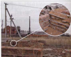
Рис. 2. Пустотный кирпич в незавершенном строительстве
